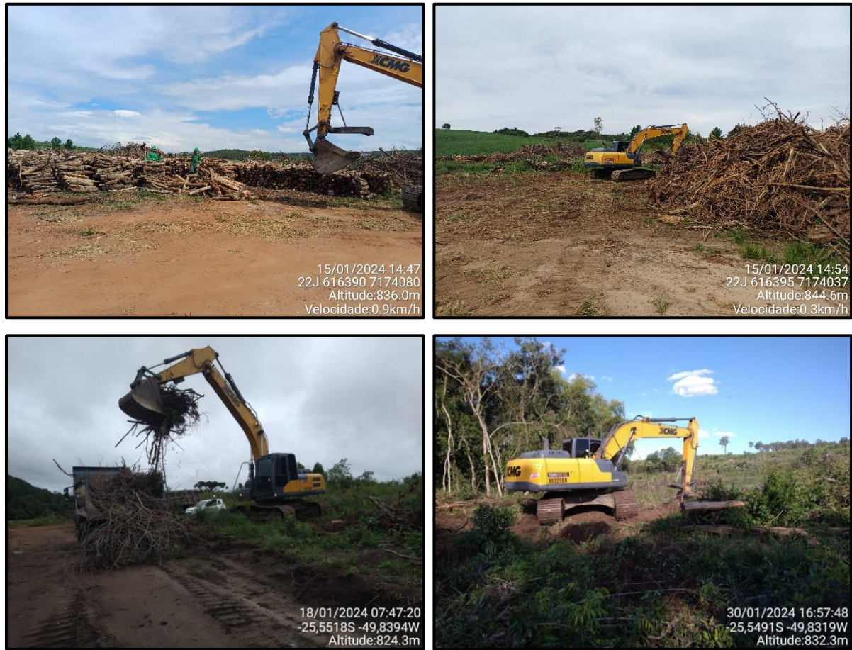
Figura 44 - Execução das atividades de limpeza vegetal nas áreas do futuro reservatório realizada no mês de janeiro de 2024.
