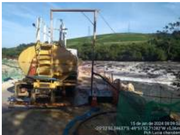
Figura 20 – Captação de água superficial
