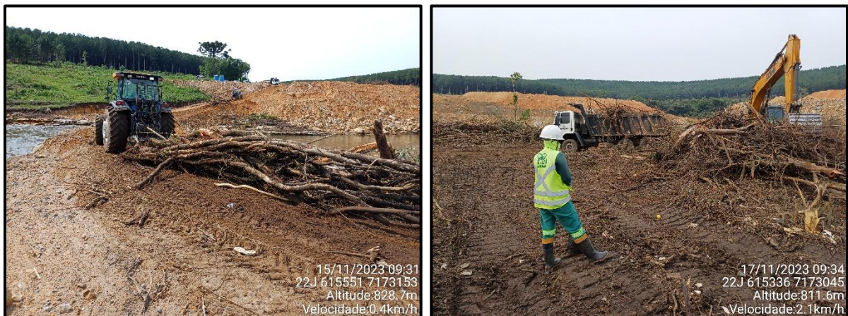
Figura 41 - Execução das atividades de limpeza vegetal das ilhas (futuro reservatório) realizada no mês de novembro de 2023.
