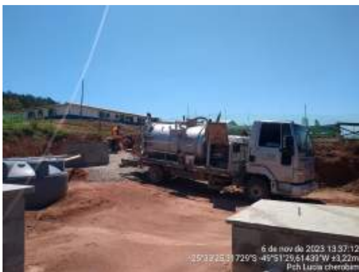
Figura 13 – Limpeza do caixa gradeada - ETE
