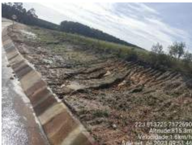
Figura 21 – Acompanhamento de processos erosivos
