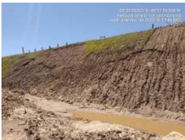
Figura 25 – Acompanhamento de ocorrência de erosão
