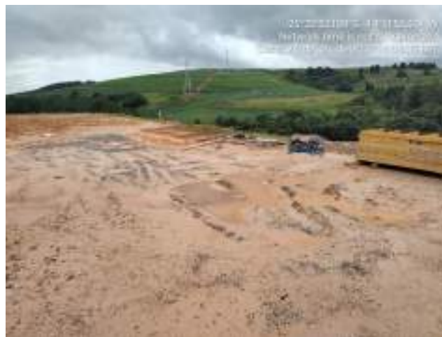
Figura 33 – Monitoramento de processo erosivo – p40
