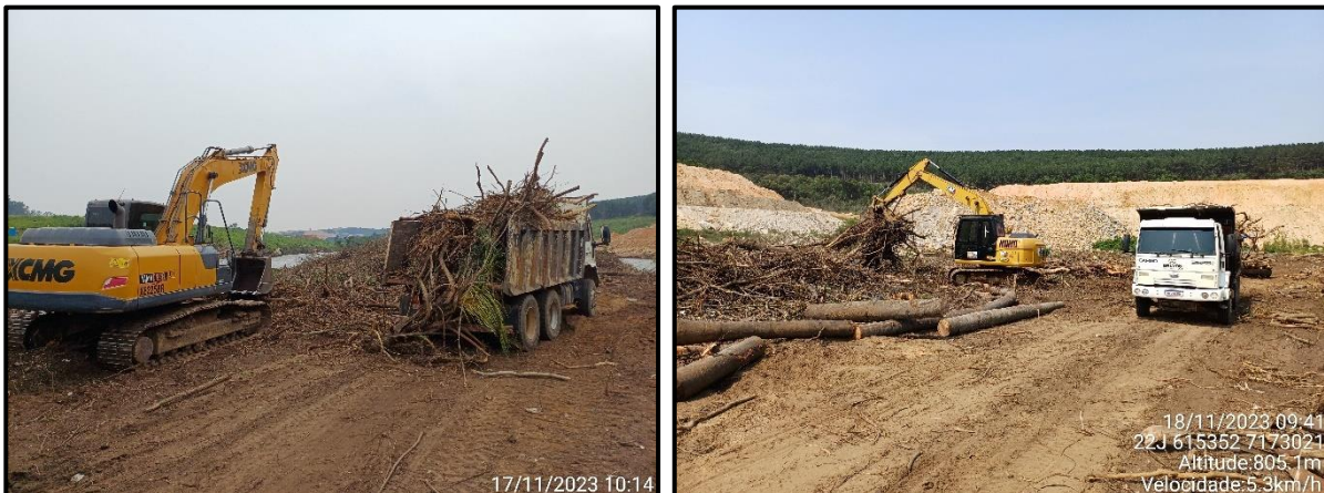
Figura 42 - Execução das atividades de limpeza vegetal das ilhas (futuro reservatório) realizada no mês de novembro de 2023.
