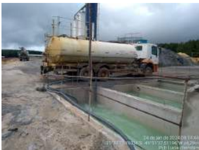
Figura 12 – Decantador industrial - - retirada de água
