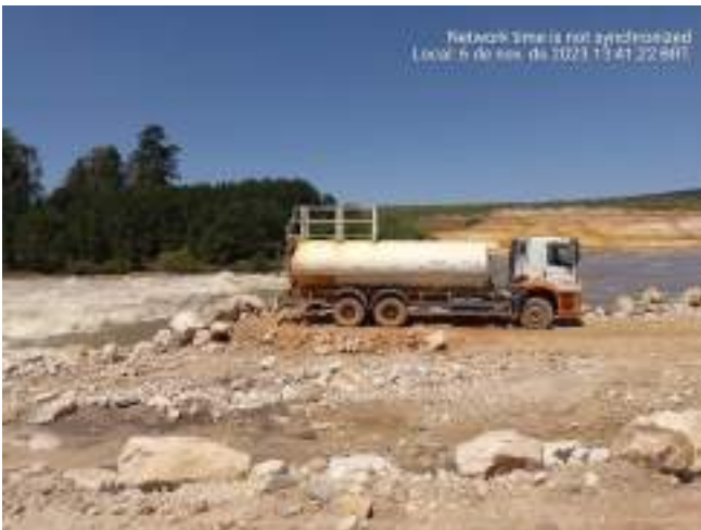
Figura 17 – Captação de água superficial
