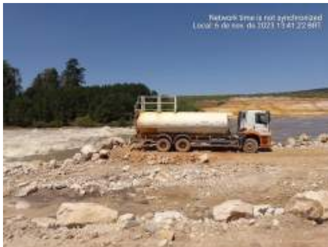
Figura 17 – Captação de água superficial
