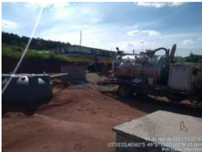
Figura 11 – Limpeza da caixa gradeada - ETE
