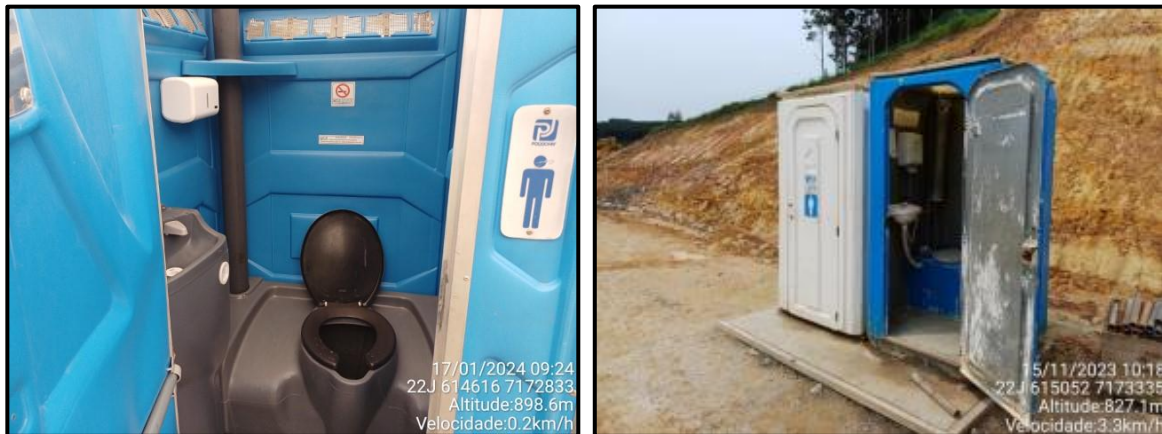
Figura 14 - Registros fotográficos das inspeções realizadas nos banheiros químicos e vestiários instalados no empreendimento.
