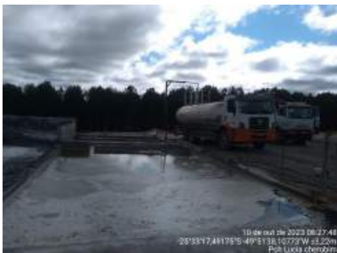
Figura 13 – Decantador industrial - - retirada de água
