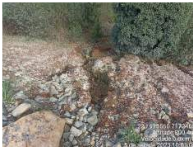
Figura 22 - Acompanhamento de processos erosivos
