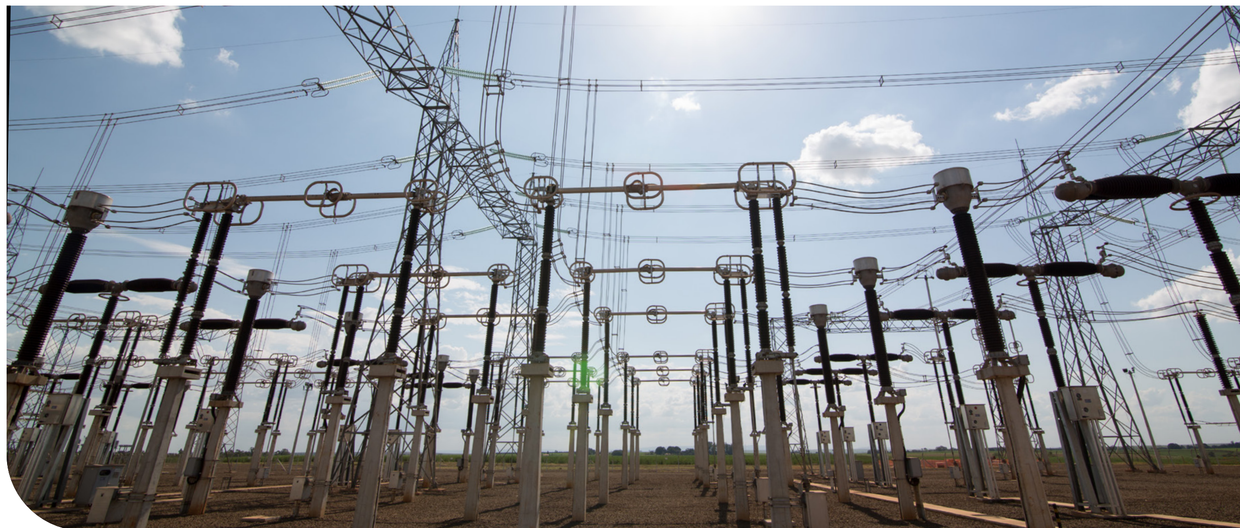
Subestação Piracicaba, em São Paulo.
