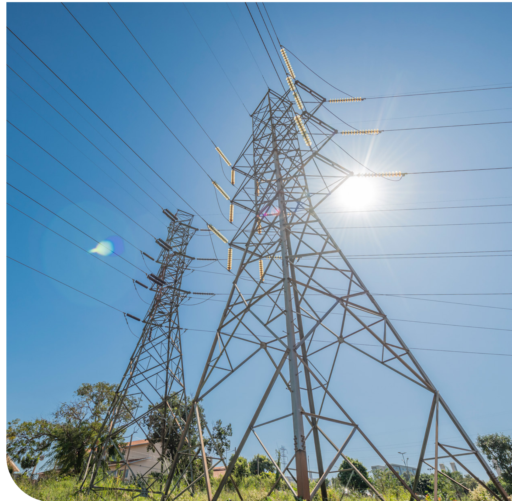
Torres de subtransmissão em Araraquara (SP).
