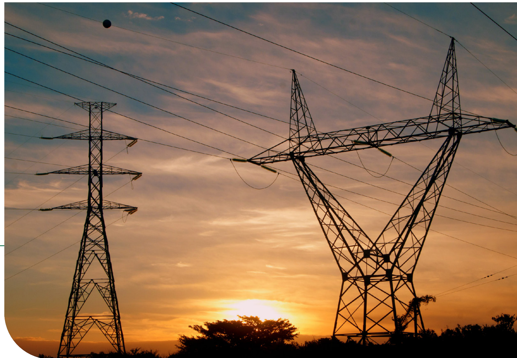
Linha de transmissão em Rio Grande (RS).
