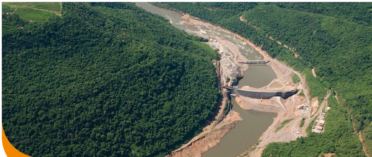
Usina Hidrelétrica Castro Alves (Ceran)
