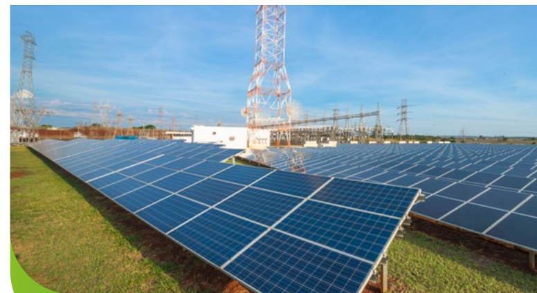
Usina Fotovoltaica de Tanquinho em Campinas - SP
