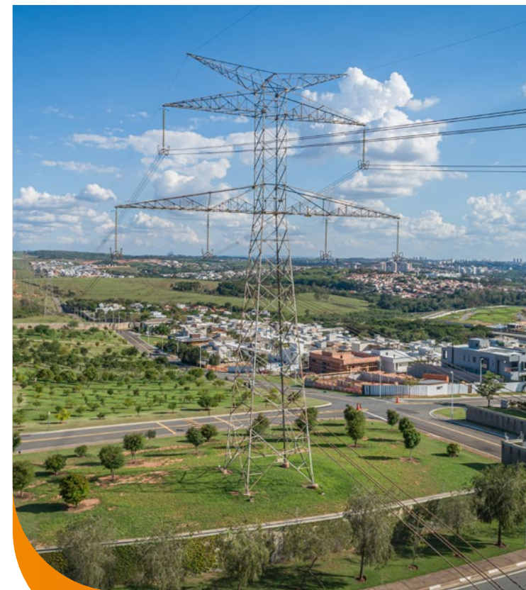
Torre de transmissão Campinas - SP
